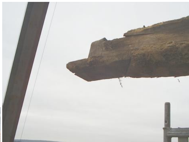
Endlich ist der Balken in der Luft. Wie schadhaft er ist, lässt sich auf diesem Bild deutlich erkennen.
